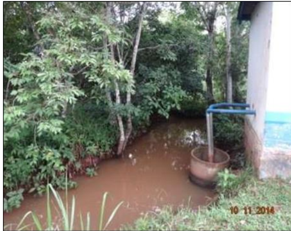
Figura 23 - Captação de água Fonte: E.C.P. Soluções (2014).
