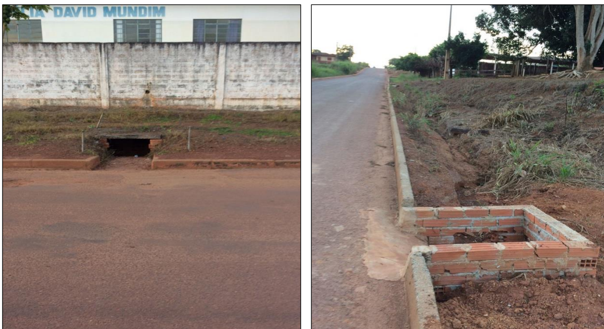
Figura 114- Dispositivos coletores de águas pluviais no município de Espigão do Oeste Fonte: ECP Soluções, 2017.
