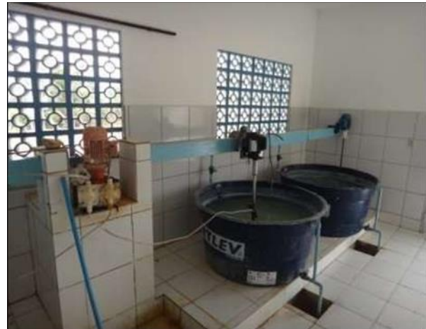
Figura 37 - Tanques de preparo dos produtos químicos Fonte: E.C.P. Soluções (2014).
