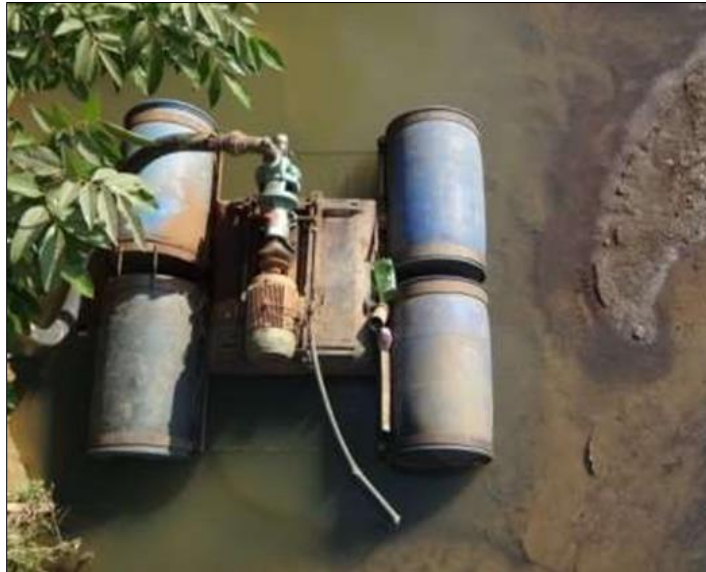
Figura 25 - Sistema de captação de água
