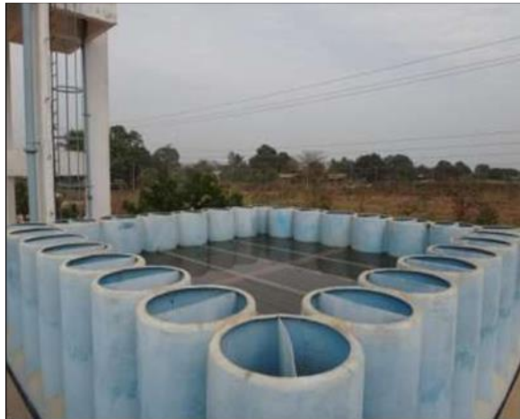
Figura 36 - Flocculação e decantação Fonte: E.C.P. Soluções (2014).
