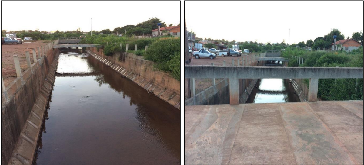
Figura 112- Canal de Macro drenagem em Espigão do Oeste
