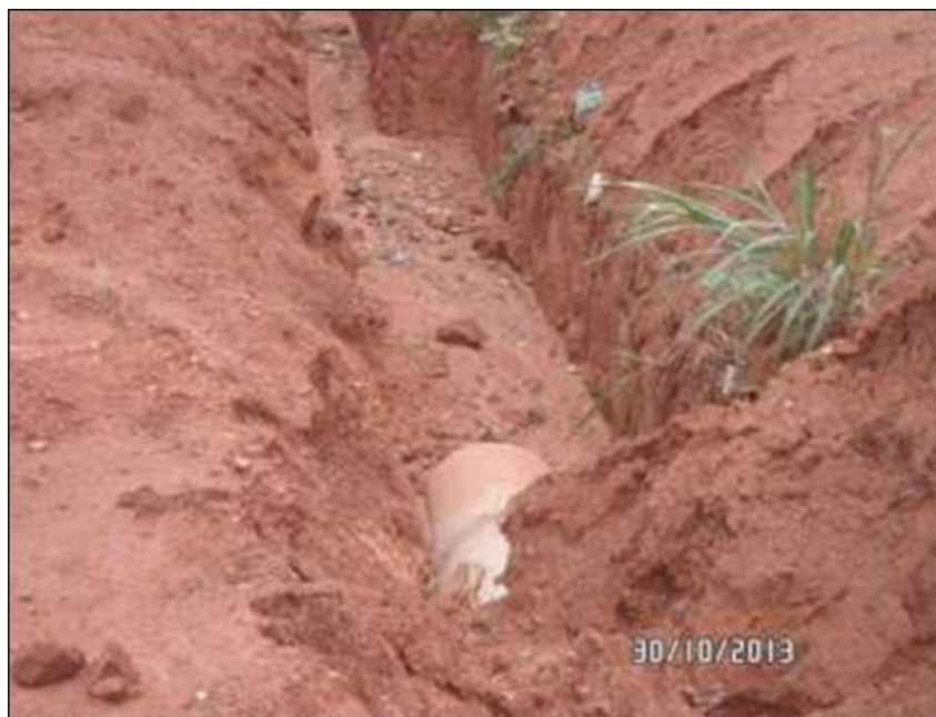
Figura 78 - Obstrução do canal de microdrenagem inacabado
