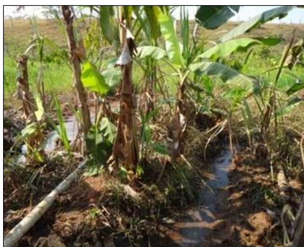
Figura 55 - Lançamento esgoto in natura em córregos
