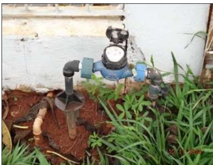
Figura 46 - Hidrômetro instalado na residência
