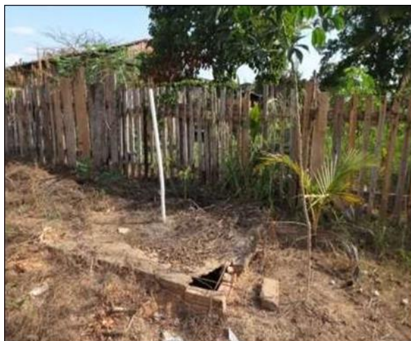
Figura 53 - Fossa negra para destinação do esgoto doméstico Fonte: Google (2013).
