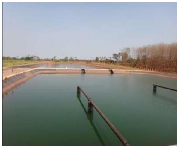
Figura 59 - Lagoas anaeróbia e facultativa da ETE
