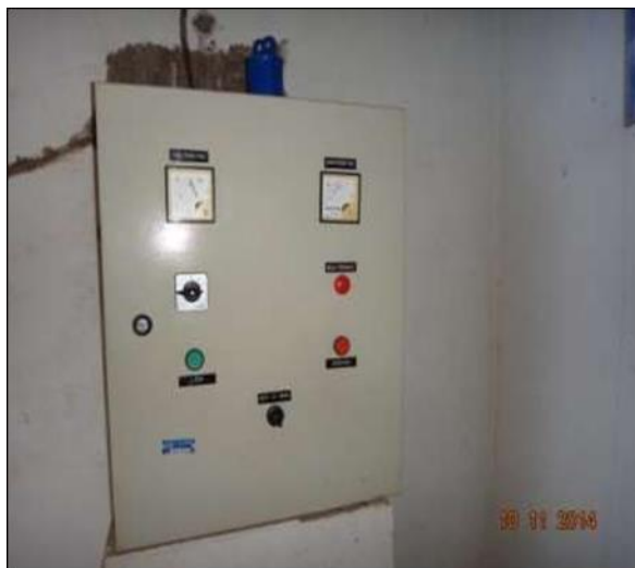
Figura 38 - Painel elétrico da EEAT
