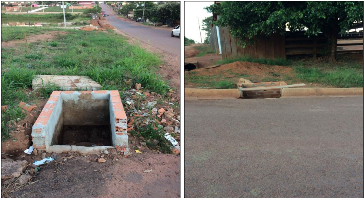
Figura 113- Boca de lobo mal dimensionada
