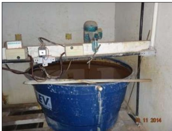
Figura 28 - Preparo do sulfato de alumínio
